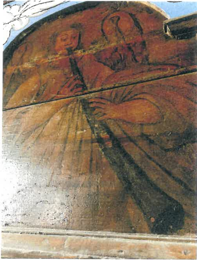
Fot. 5 Przedstawieni świętych, widoczne rozspojenia desek
