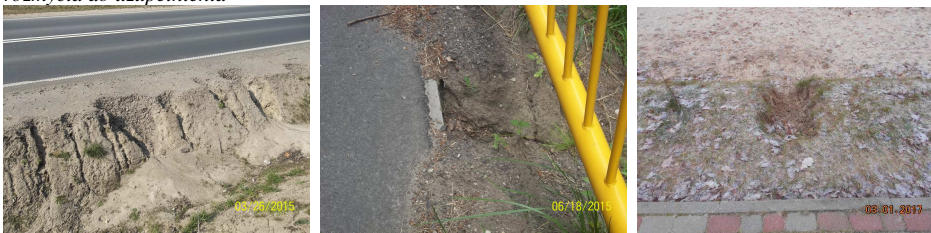
Skarpy, pobocza rozmycia do uzupełnienia
