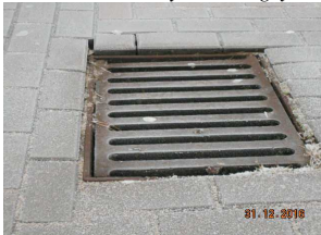
Kratki ściekowe , pokrywy włazów zaniżenie lub zawyżenie względem nawierzchni o 0,5 cm do regulacji
