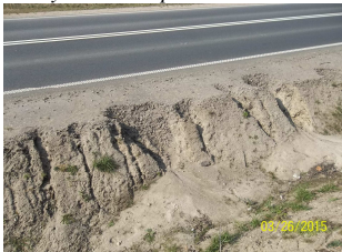
Skarpy, pobocza rozmycia do uzupełnienia
