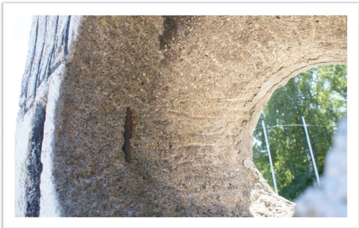
Fot. 6 Zbyt płytko osadzony, skorodowany pręt zbrojeniowy.
