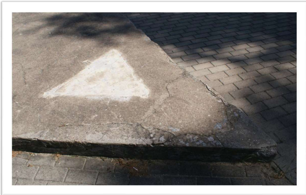
Fot.14 Ślad po istniejącym do 2012 roku betonowym bloku o podstawie trójkąta.
