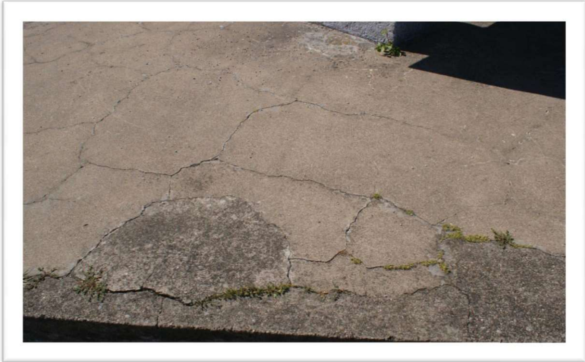
Fot. 13. Zły stan postumentu na którym stoi pomnik, postępująca korozja biologiczna.
