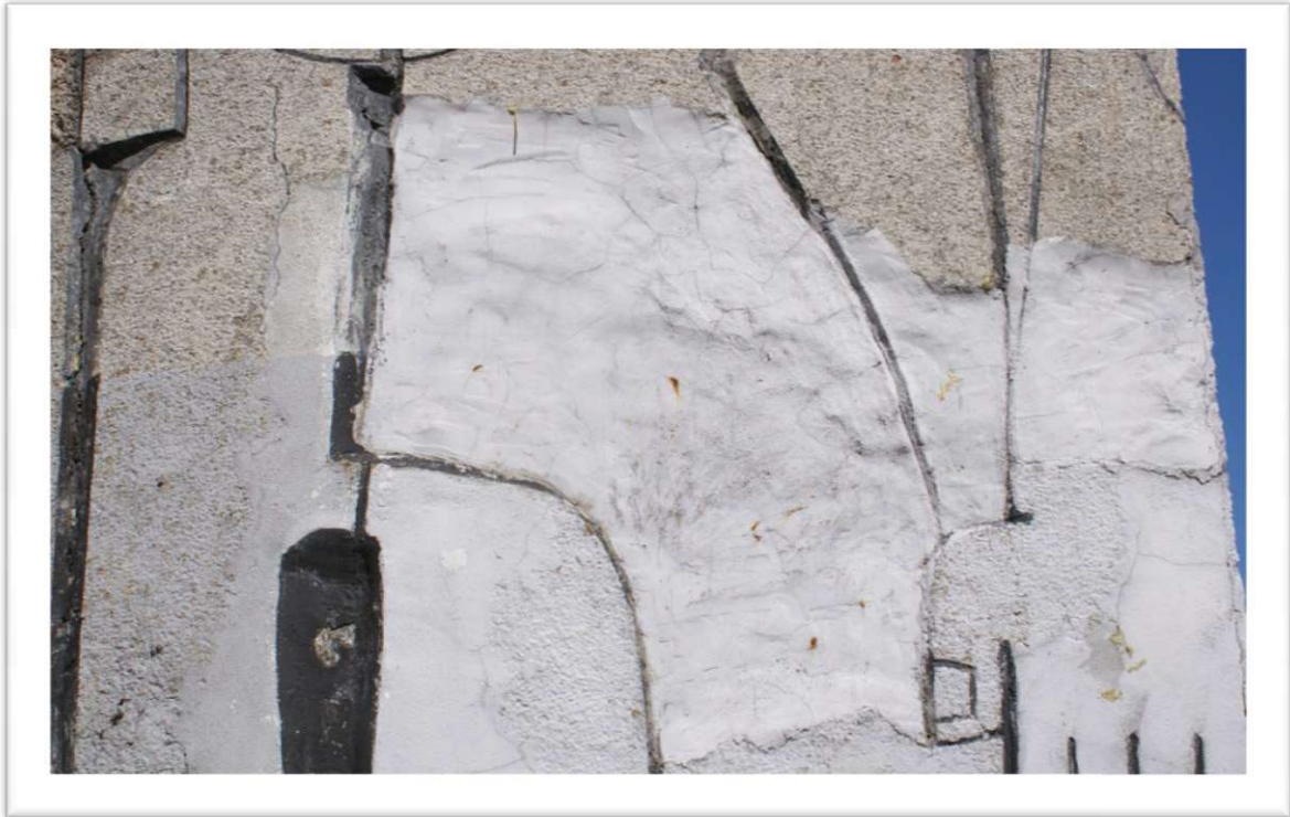
Fot.10 Widoczne produkty korozji zbrojenia przenikające przez warstwę wtórnej zaprawy uzupełniającej.
