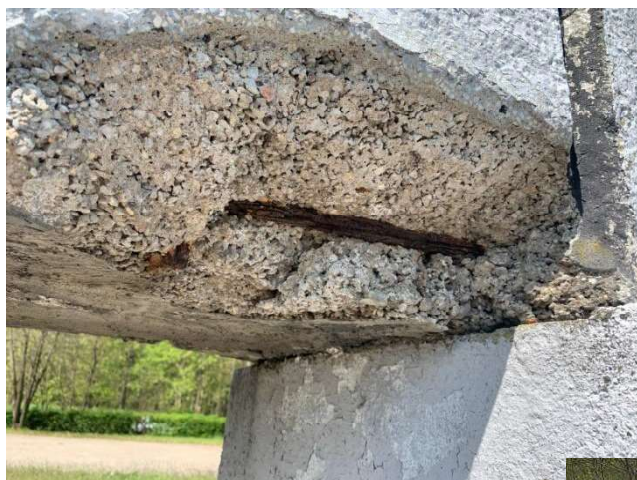
Fot. 1 Widoczna korozja warstwowa prętów zbrojeniowych.
