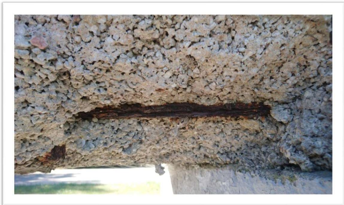
Fot. 2 Korozja warstwowa pręta zbrojeniowego.
