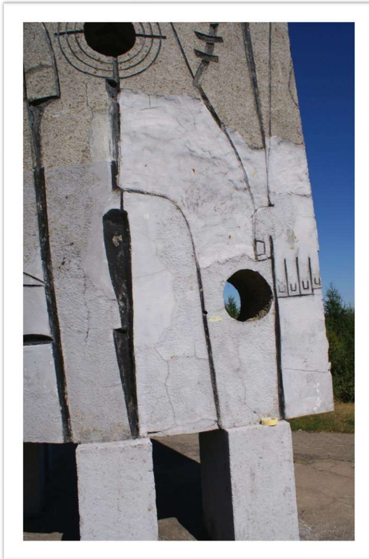
Fot. 9 Widoczne wtórne uzupełnienie dużego ubytku warstwy zewnętrznej oraz powłoka malarska.
