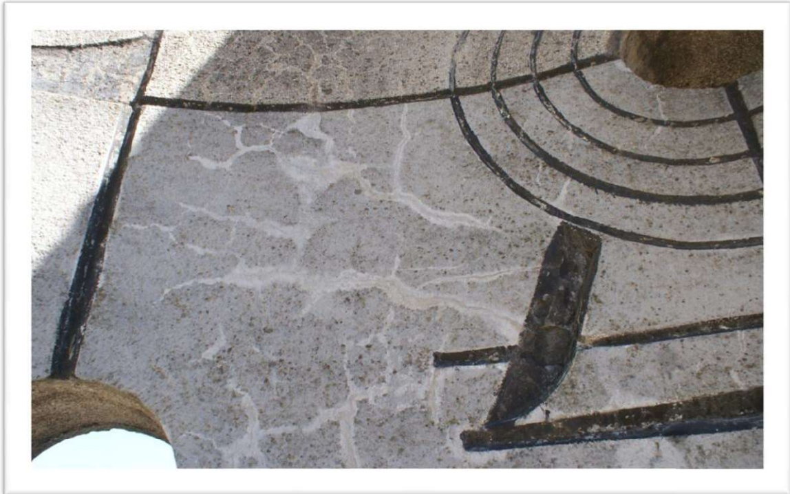
Fot.3 Charakterystyczne spękania betonu uszczelnione węglanem wapnia.
