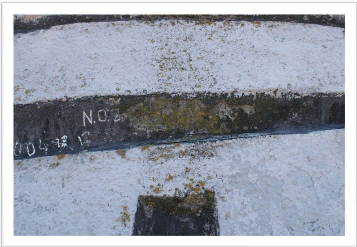
Fot.8 Korozja biologiczna na powierzchni pomnika.
