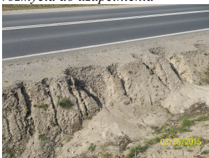
Skarpy, pobocza rozmycia do uzupełnienia
